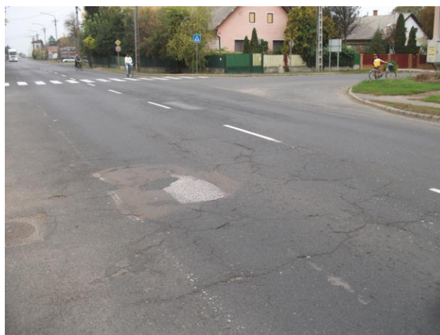
3. kép: 4. sz. főút 139 km szelvény közelében (37 éves felső aszfaltréteg)
