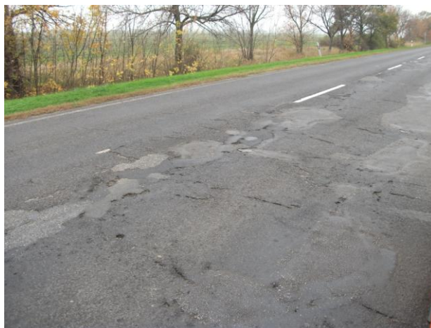
2. kép: 32. sz. főút 77 km szelvény közelében (19 éves felső aszfaltréteg)
